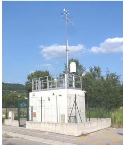
Stazione fissa ARPAV di Chiampo
